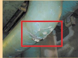
石綿含有保温材(配管曲がり部)
