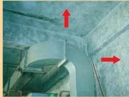
吸音用吹付け石綿・石綿含有吹付けロックウール(天井・壁等)
