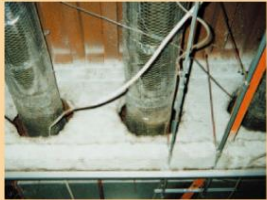
耐火被覆用吹付け石綿・石綿含有吹付けロックウール(S造の柱・梁等)
