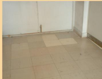
石綿含有ビニール床タイル(床)
