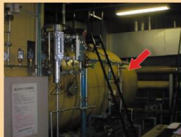
石綿含有保温材(ボイラ外周部)
