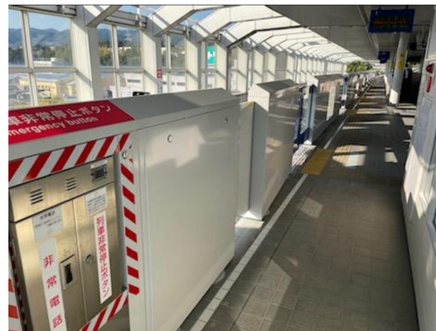
大阪モノレール豊川駅（設置後）
