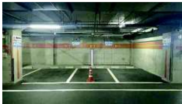
写真 中央公園駐車場 EV 車用充電スタンド
