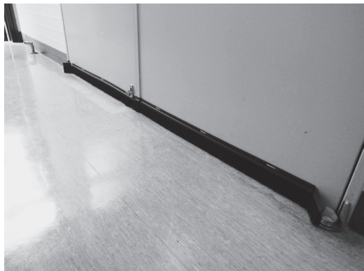
写真2 第2収蔵庫（特別収蔵庫）扉 ドア隙間対策用ブラシ設置
