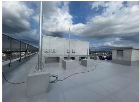
最上階に設備機器を設置しています。
