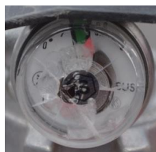
× 指示圧力計の損傷
