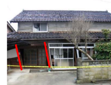
1 階部分が傾斜している
