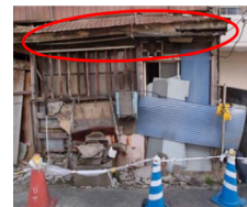
軒の不陸、剥離が生じている
