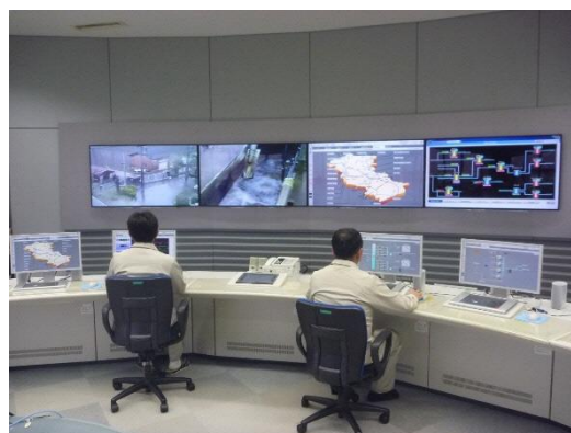
十日市浄水場中央監視室
